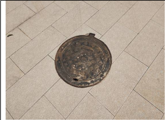
项目已纳入当地市政污水管网
